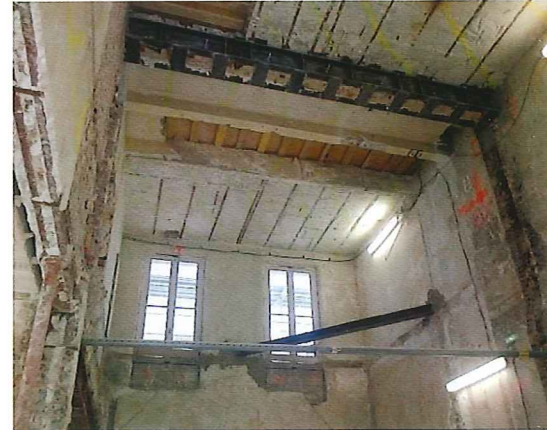
Poutre métallique de reprise pour maintien des étages 3 et 4 ainsi que la démolition des niveaux inférieurs
